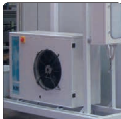
Unità moto condensante (anche tropicalizzata) installata su basamento antivibrante completa di serbatoio di raccolta del liquido e compressore. Condensazione ad aria mediante un condensatore realizzato in tubo di rame con superficie radiante in alette di alluminio e completo di un elettroventilatore. Rumorosità molto contenuta.
