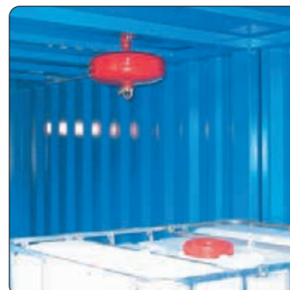
Estintore automatico a polvere A.B.C. Sprinkler ad intervento automatico alla temperatura di 68°/72°
