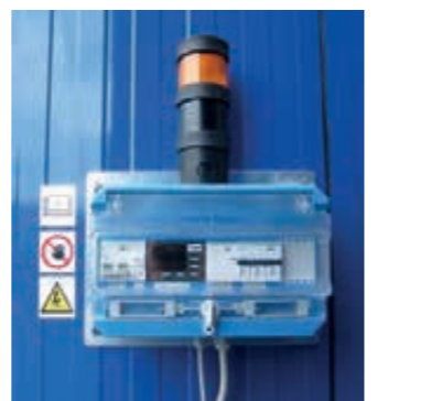
CENTRALINA DI COMANDO IMPIANTO ELETTRICO
