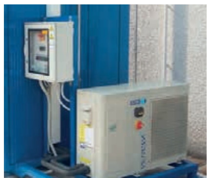
UNITA' MOTOCONDENSANTE ESTERNA CON QUADRO DI COMANDO
