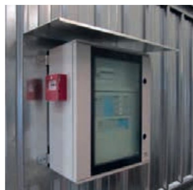
CENTRALINA DI UN IMPIANTO ANTINCENDIO
