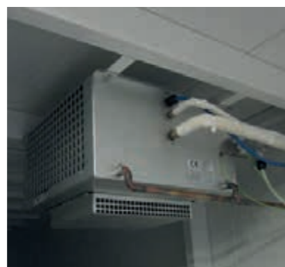
AEROEVAPOREATORE INTERNO IMPIANTO DI CLIMATIZZAZIONE
